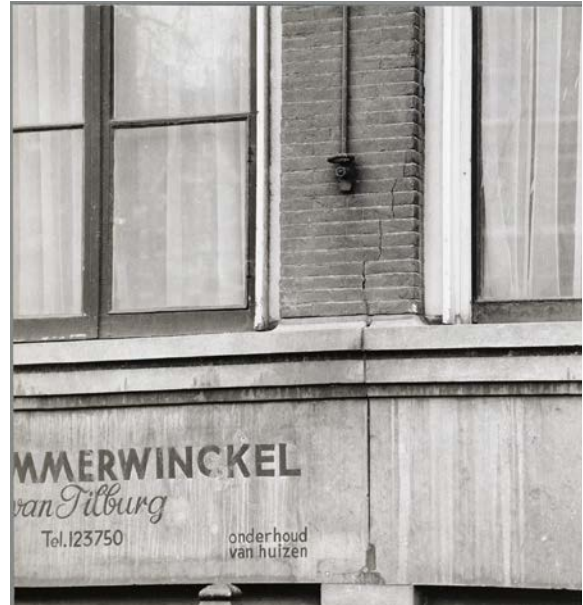
Schade aan de 'Timmerwinckel'.
