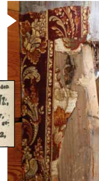
Restanten van desierbanden van het behang dat in het derde kwart van de 19e eeuw op zolder werd aangebracht
