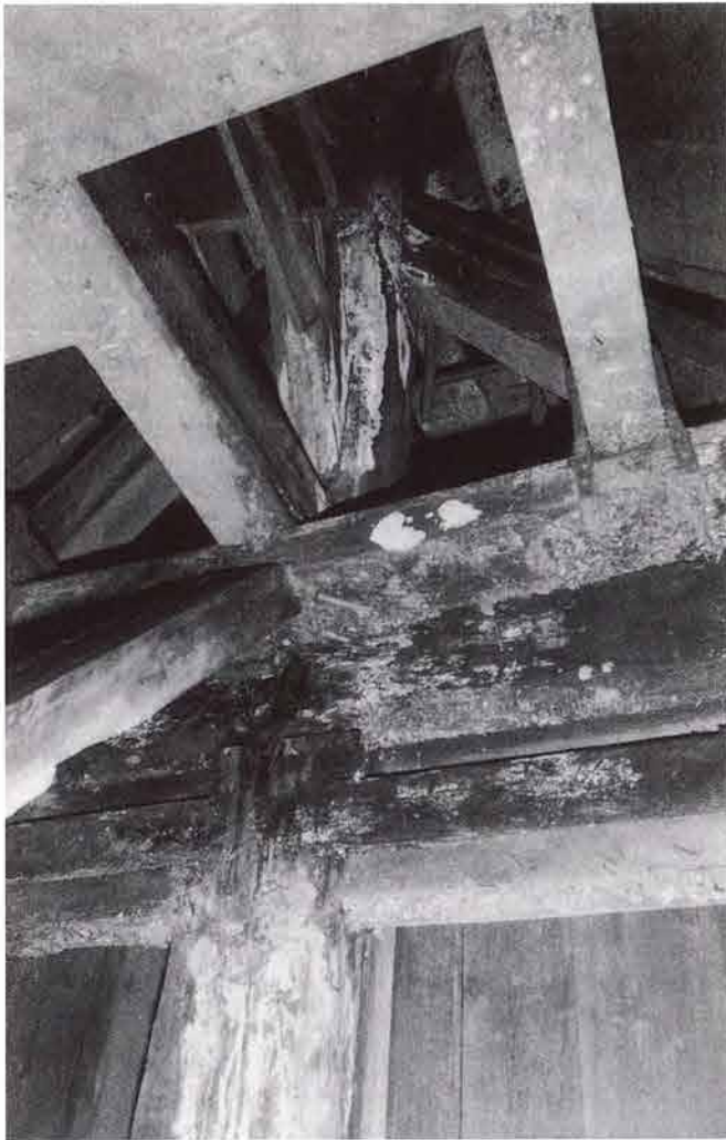
De skeletconstructie onder de dakgoot; volledig door zwam verteerd. (Stadsherstel).
