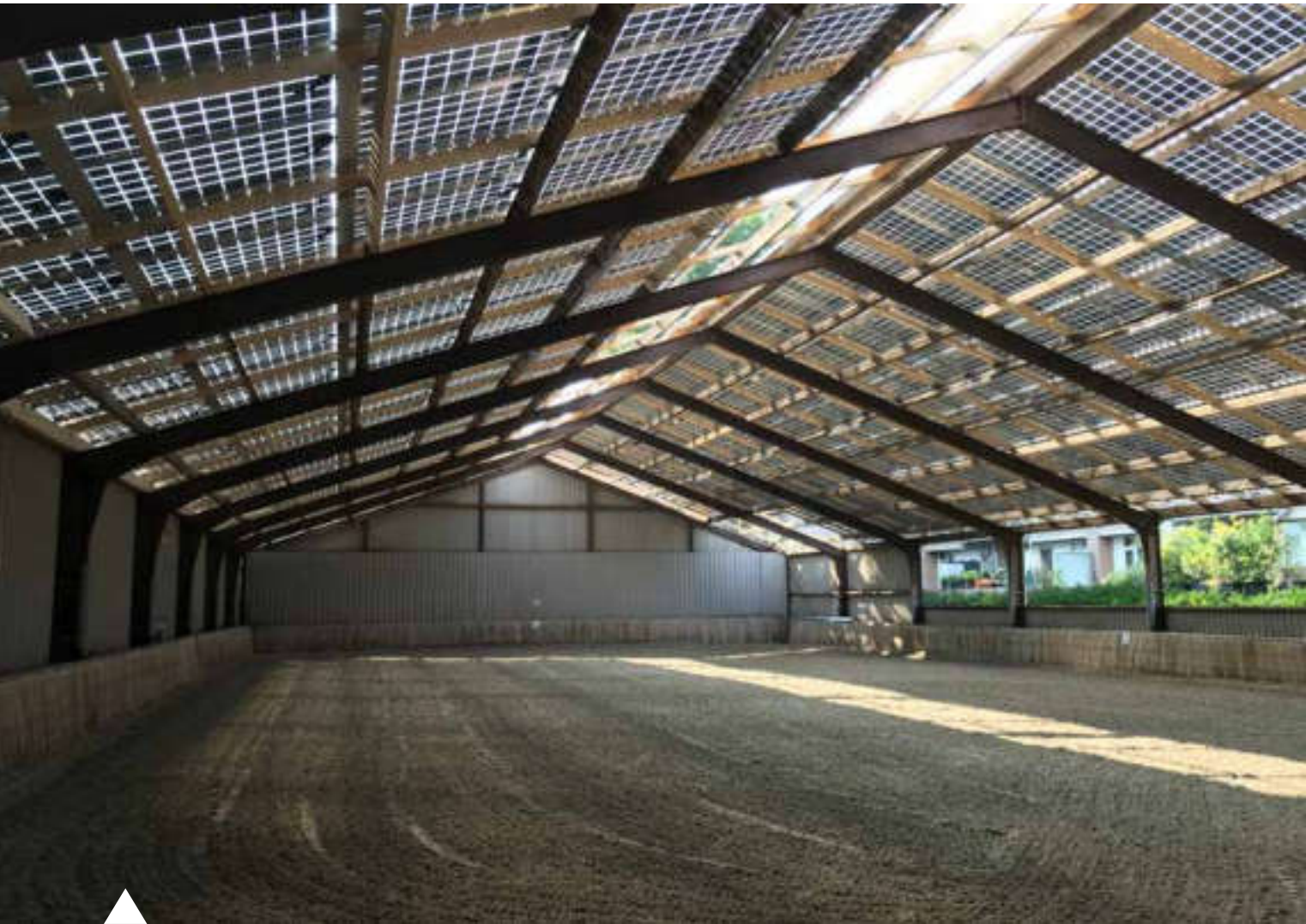
Lichtdoorlatende zonnepanelen aan beide zijden op het dak van de buitenbak van de Hollandsche Manege WILLEM VAN ITERSON
